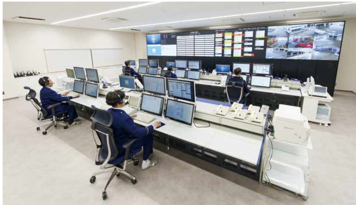
新高機能消防指令システム
